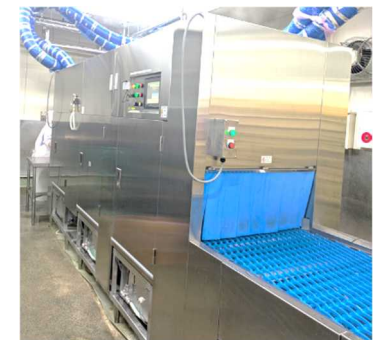
R7-8 設備導入 (大型食器洗浄機)
